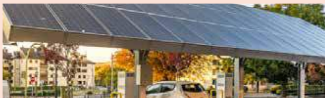
Zonnepanelen bij Park&Ride NS station
